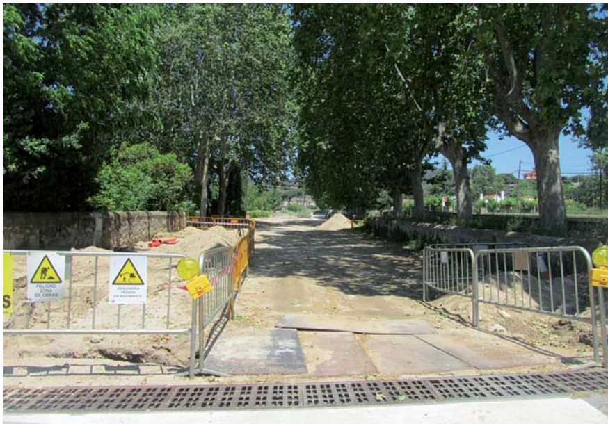
Les obres han començat aquest mes de maig i tenen un termini d'execució de cinc mesos.
