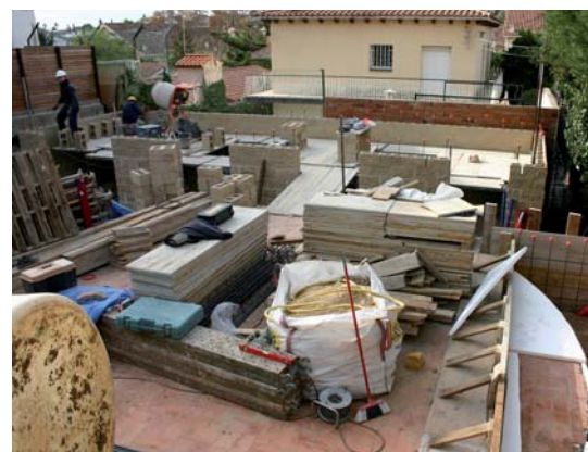
A dalt, imatge del repartidor de la mina de Can Sors. A sota, treballs de construcció de les instal·lacions.
